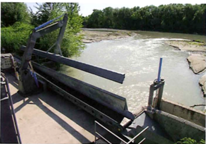
La centralina idroelettrica e il canale di derivazione, con primo piano dello sgrigliatore, della centralina di S. Cesario. (Foto Aquilino Richeldi)
